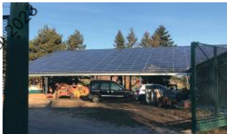
Toit de panneaux photovoltaïques sur hangar agricole à Mison _Cittànova
